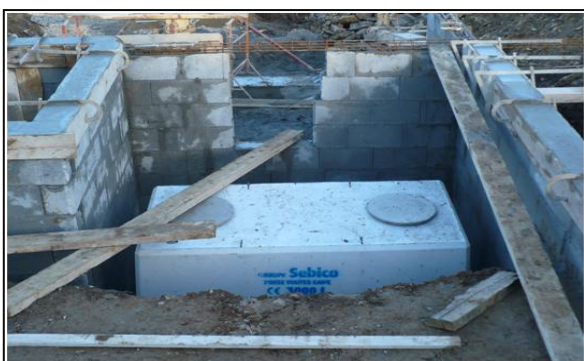
Cuve de récupération des eaux de pluie
