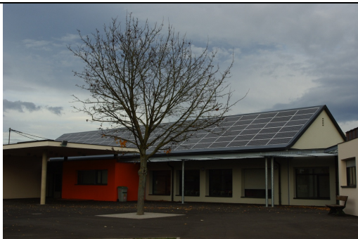
Chantier réalisé par ELECSOL et HB couverture sur une école primaire, fourniture FR énergies.
