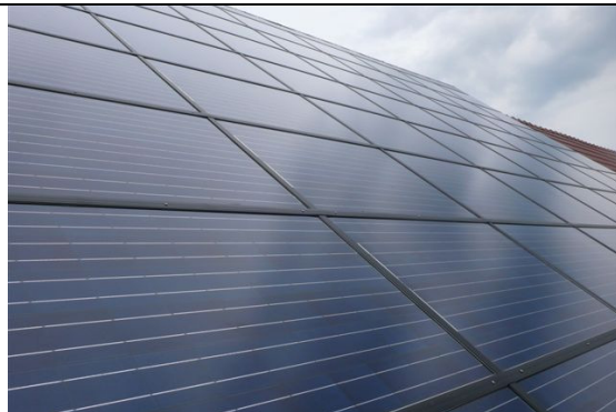
Chantier réalisé par ELECSOL, Baxol avec anodisation noire, fourniture FR énergies.
