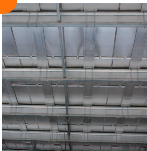
Vue de dessous des tôles anti-condensation.
