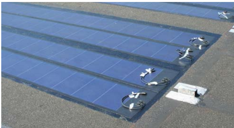
Cellules Soprasolar Cell avant raccordement au réseau électrique
