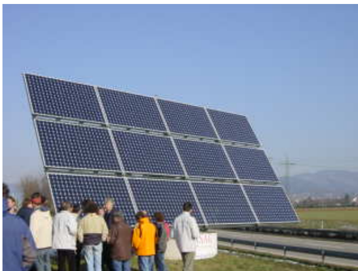
Figure 59 : Système de suivi SAG (modules SunPower) à Freiburg
