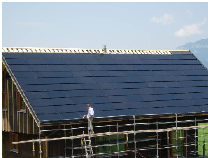
Figure 106 : 240 modules Sulfurcell / SolRif sur la « Maison ZEN » de Mr Ricaud à Montagnole
