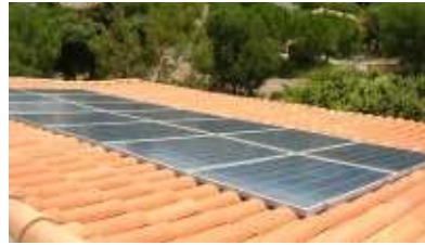
Panneaux intégrés au bâti sur bac acier
